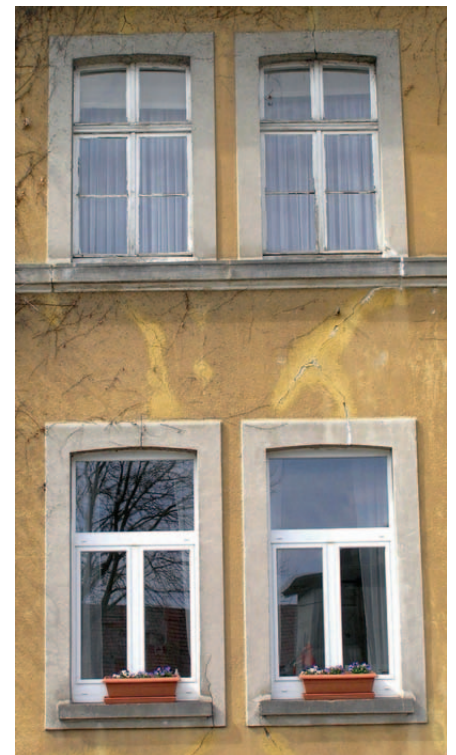
Abb. 2: Beeinträchtigung des Erscheinungsbildes durch Fensterverlust.
