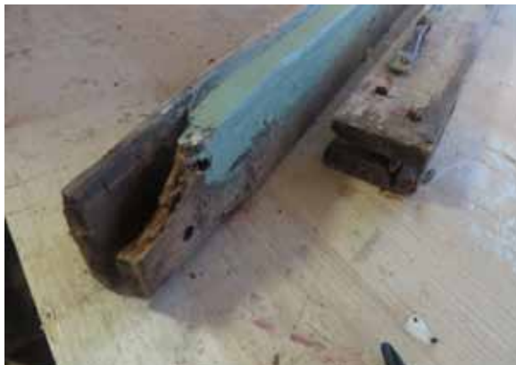
An diesen Fensterprofilen hat der Zahn der Zeit genagt. Und doch konnten sie dank exakter Musterreparatur und detaillierter Arbeitsdokumentation problemlos von einem Zimmermann instand gesetzt werden. Foto: Hanspeter Odermatt
