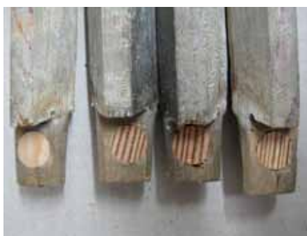
Kleine Reparatur, große Wirkung: Nach Bearbeiten der Querholzdübel bekommen die Holzdübel in den neuen Bohrungen für die nächsten Jahrzehnte wieder einen festen Sitz.
